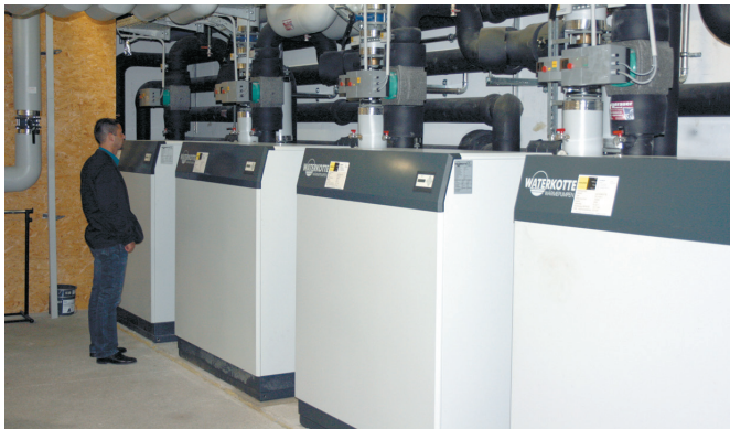
4 Wärmepumpen sorgen für wohlige Wärme im Neubau des 4 Sterne Hotels Crystal Foto: Rainalter
